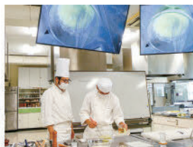
食物調理科 天井設置カメラシステム
